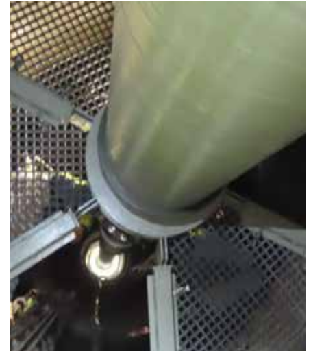
Bild 16: neues Abgasrohr, mit Blick unter die 52 m Bühne
