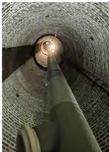
Bild 15: neues Abgasrohr mit Rauchgasanschluss
