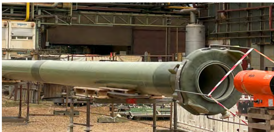
Bild 3: oberstes Segment des neuen Abgasrohres mit Tropfenfang, wurde vor dem Einhub beheizt
