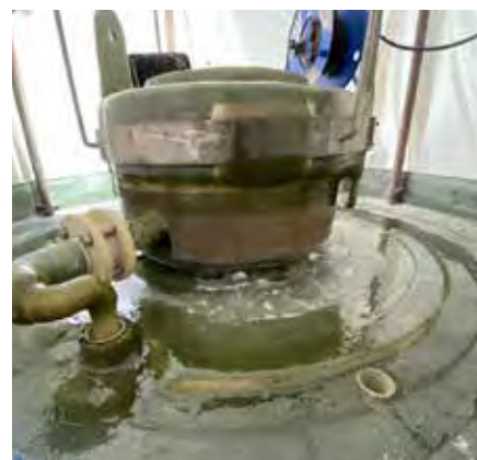
Bild 5: Mündung mit neuer GFK-Abdeckung
